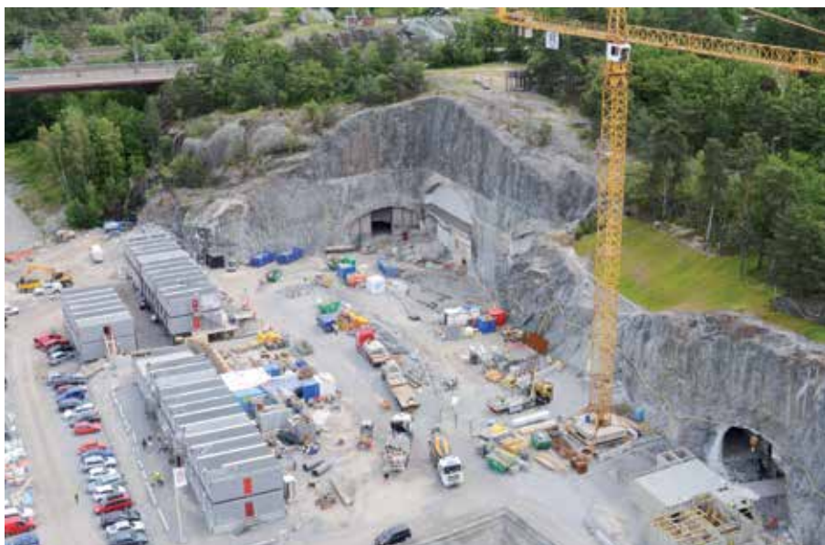
Bergrumsgaraget består av 47 000 kvm golvyta och har en volym på 230 000 kubikmeter fördelat på fem bergtrum med ett djup på 150 m vardera. På bildens högra nederkant ses uppförandet av Berghus 2.
